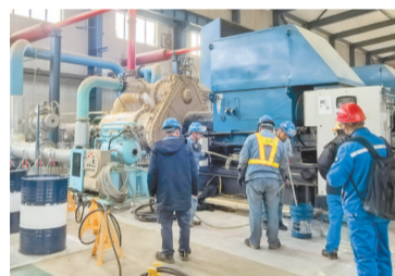
工作人员为设备更换润滑油。 本报通讯员 杨勇 霍树琳 摄
