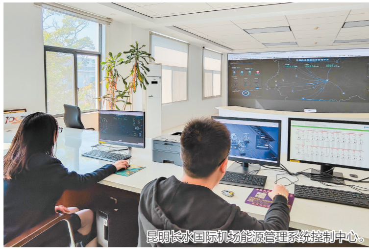
昆明长水国际机场能源管理系统控制中心。
