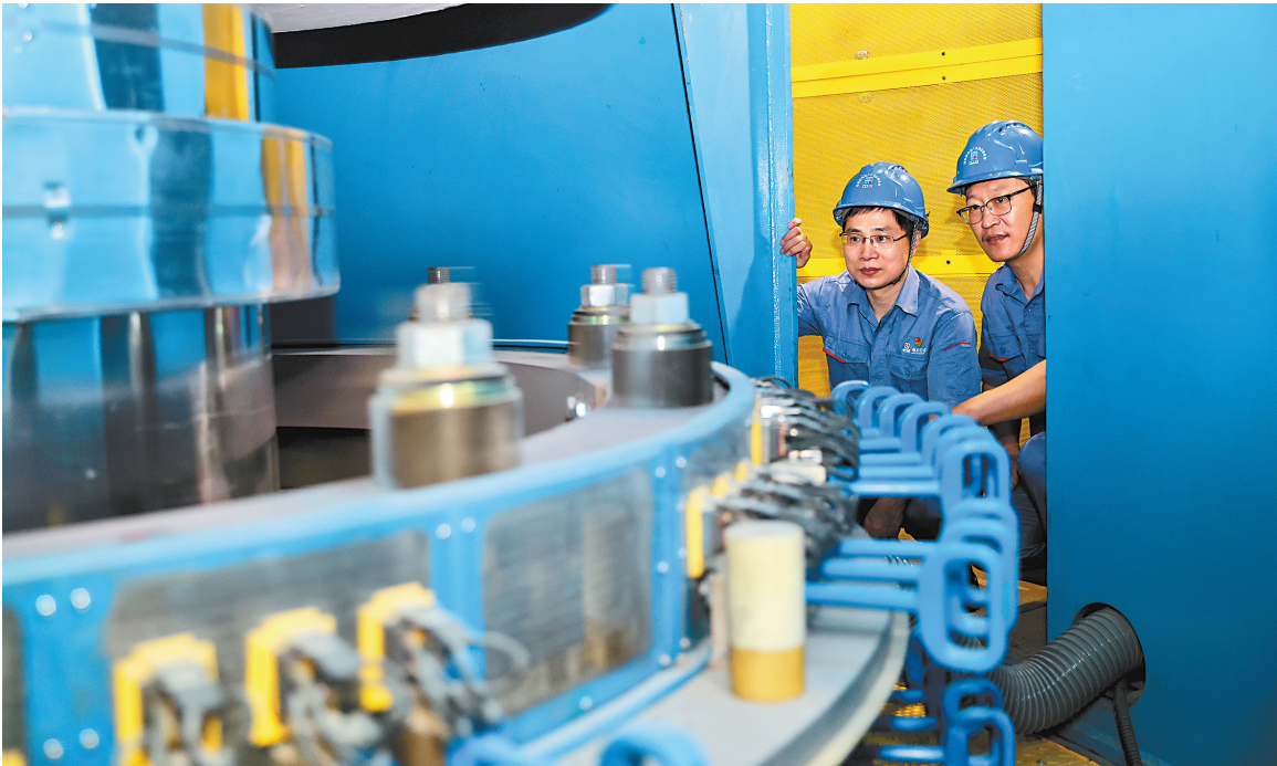
工作人员正在检视世界单机容量最大的白鹤滩水电站右岸(云南侧)14 号机组运行情况。 本报记者 雷桐苏 摄
